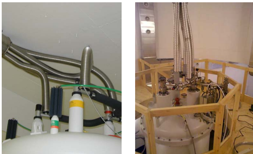
Figura 6.5. Tuberías de emergencia de quench
